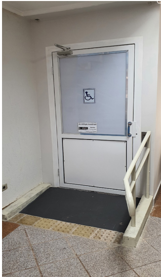
Elevador de uso restrito à acessibilidade
